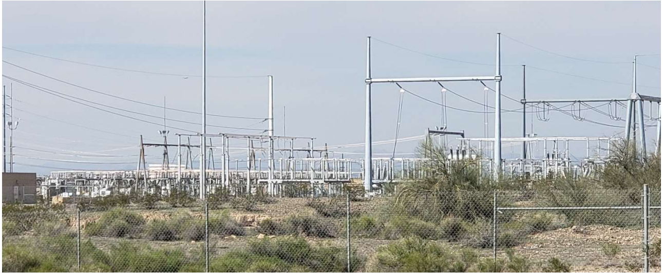
El Sol 230/69kV Substation
