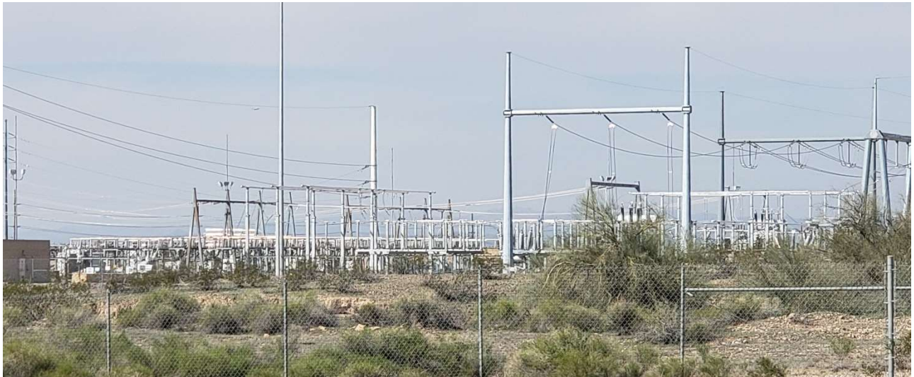
El Sol 230/69kV Substation
