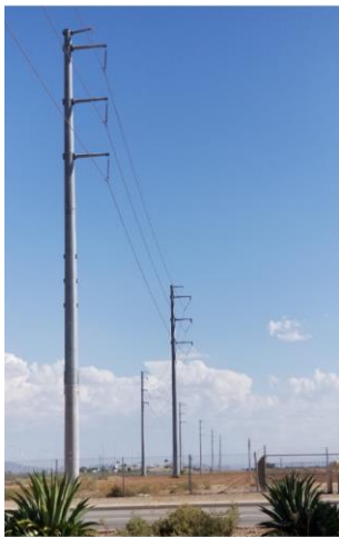
230kV single-circuit monopole
